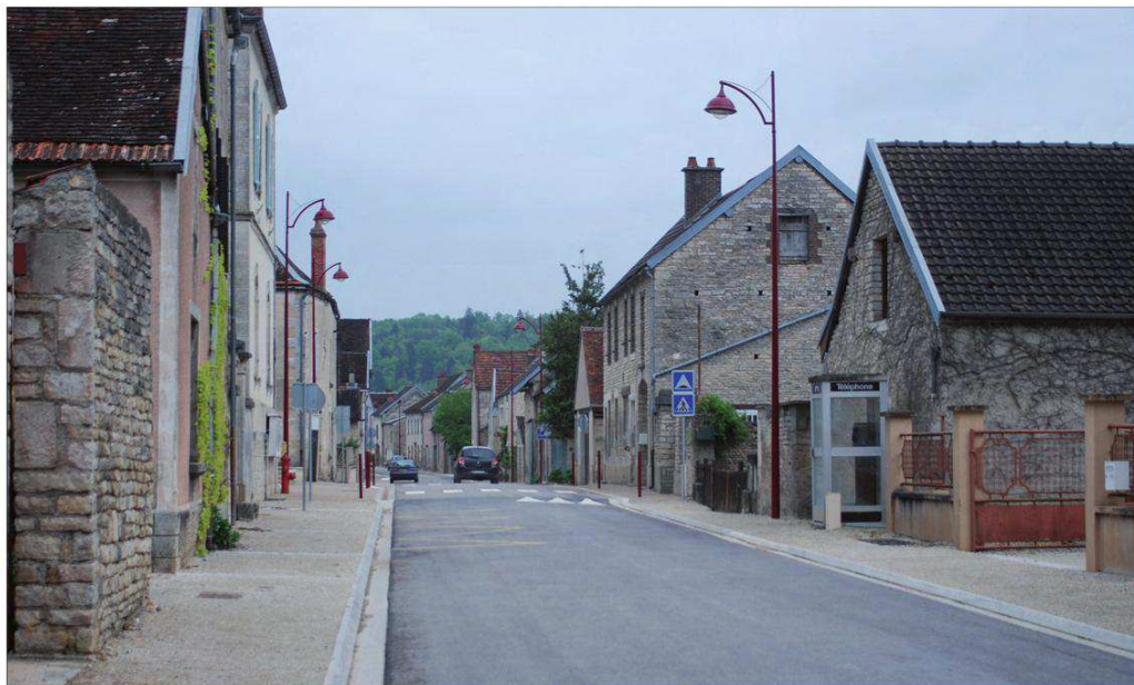
Courteron - Gyé-sur-Seine : aménagement de trottoirs en stabilisé et enfouissement des réseaux aériens.
