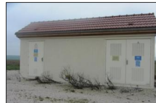
Figure 9 : Exemple de poste de livraison (Parc éolien des 4 vallées)
