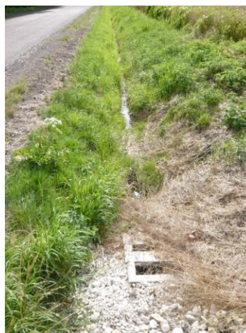
écoulement des jus dans le fossé
