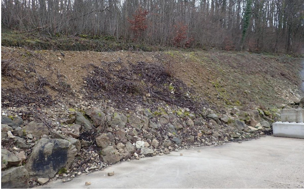
Illustration 17 – Talus anthropique en lisière de bois et du parc d'attraction (pente mesurée de 55°, léger enrochement en pied de talus, pas de formation rocheuse à l'affleurement)
