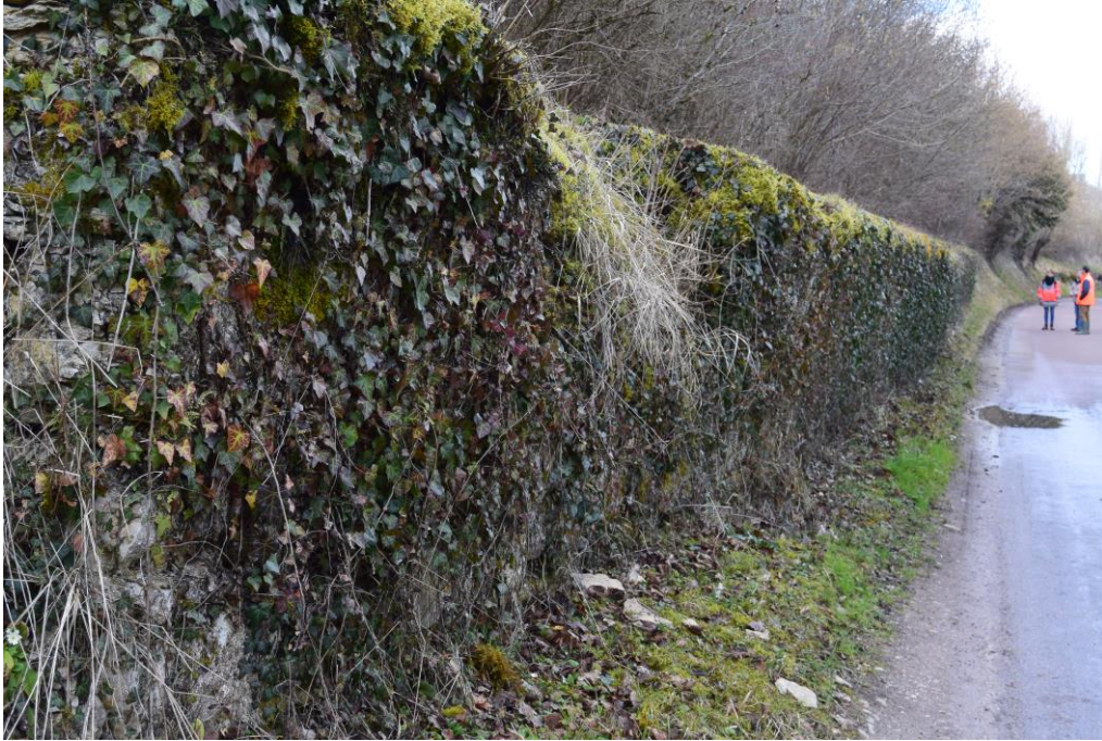
Illustration 14 – Mur basculé sur la route entre Fontaine et Bar-sur-Aube (BRGM, 2015)
