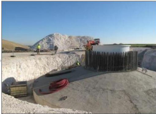
Une fois la semelle coulée, la virole est fixée à la partie supérieure de la fonction
