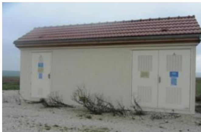
Figure 5 : Exemple illustrant un poste de livraison (Parc Éolien des 4 Vallées) – source : An Avel Braz
