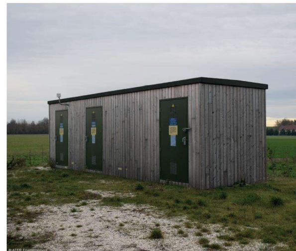
Figure 224 : Poste de livraison du parc Les Renardières, situé au Nord de Champigny-sur-Aube (source : NEOEN, 2020)
