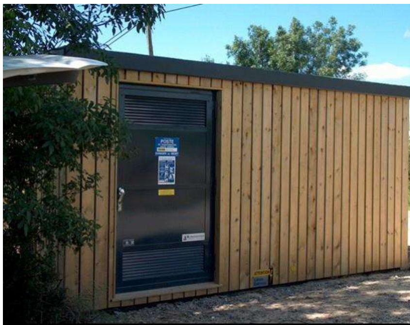
Figure 170 : Exemple de poste de livraison envisagé (source : NEOEN, 2020)
