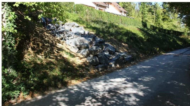
Sur la route reliant Bar-sur-Aube à Fontaine, on aperçoit un enrochement au niveau du secteur concerné par les événements de mars 2014.
