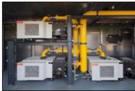
Pompes à vide Source : GASEO
