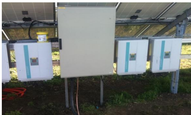
Photo 13 : Type d'onduleurs installés (Source : Kronos Solar)
