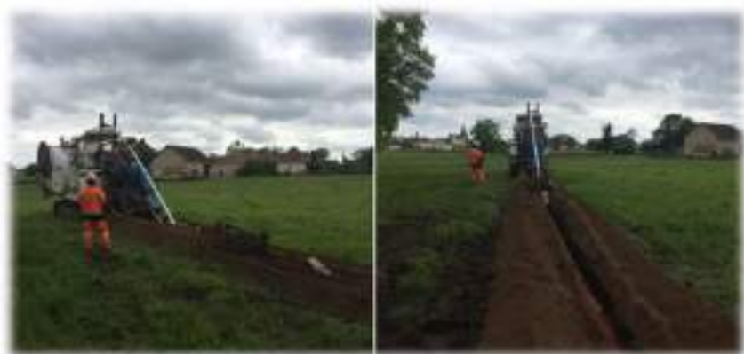
Photo 56 : Exemple de chantier d'enfouissement d'un réseau électrique en terres agricoles (source : Cegelec infra)
