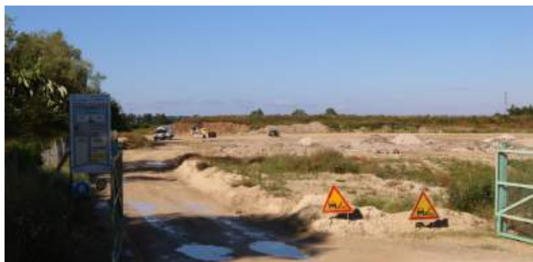
Photo 4 : Vue depuis le nord du site sur la zone en cours de remblaiement
