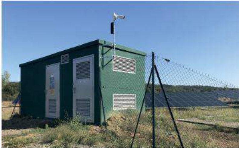
Photo 43 : Exemple de poste de livraison (Source : Urbasolar)
