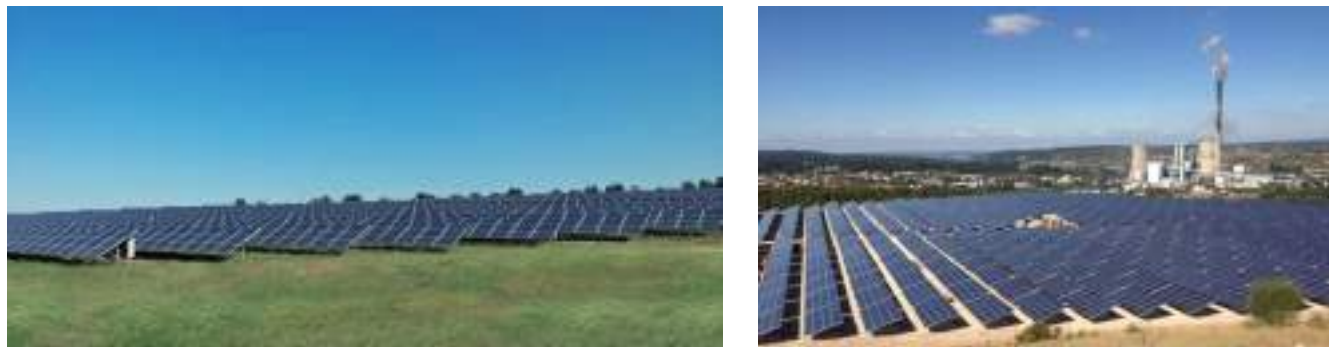
Photo 41 : Réalisations Urbasolar : à gauche, Granitec en Bulgarie. A droite, aménagement d'un ancien terril à Gardanne (13)
